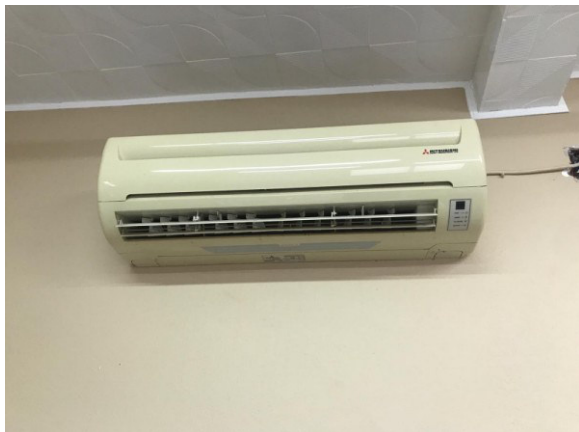
n. 2 condizionatori d'aria Mitsubischi
